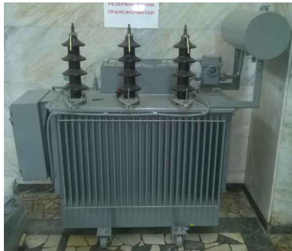
SLIKA 4 - Nov transformator 35/0,4 kV, 0,25 MVA
