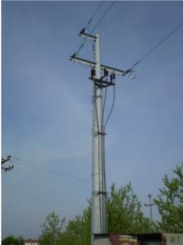
Slika 2: Izgled krajnjeg stuba i kablovskog priključka na 35kV nadzemni vod
