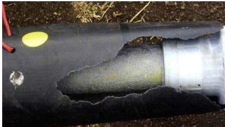
Slika 5 – Oštećenje zaštitnog omotača od ptica [3]
