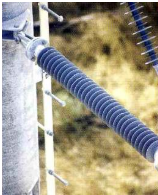
Slika 7 – Oštećeni horizontalni potporni izolator od ptica [3]
